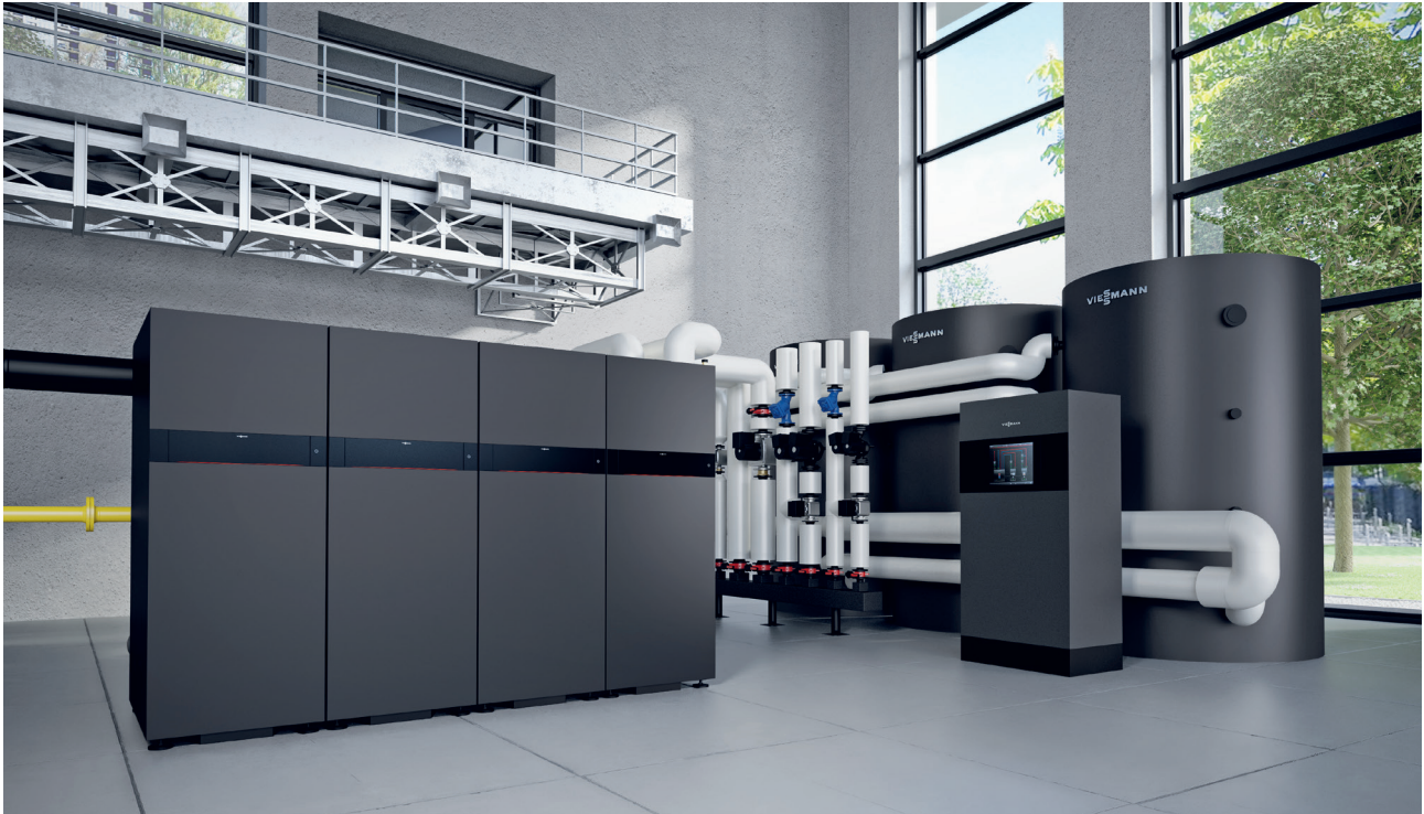
Gas-Brennwertkessel Vitocrossal 300 (Typ C13) als 4er-Kaskade, Heizwasser-Pufferspeicher Vitocell und Schaltschrank Vitocontrol (v. l.)
