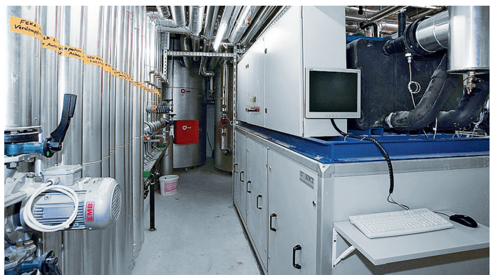
Diese Abwasser-Wärmepumpe mit einer Leistung von 150 kW wird zur Trinkwassererwärmung genutzt.
