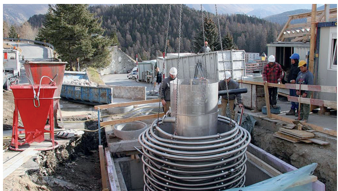
Dieser Abwasserschacht dient als Primärquelle zur Warmwasseraufbereitung.
