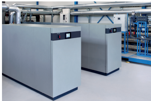
Wärmepumpen Vitocal 350-G PRO mit einer Gesamtleistung von 620 kW
